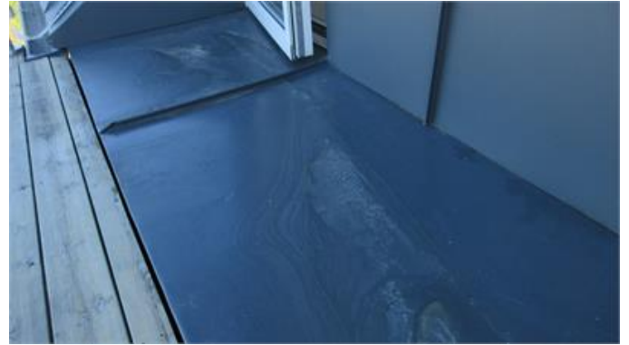
"plåtgolv" i anslutning till takkupa på balkong som har bristfälligt fall.
