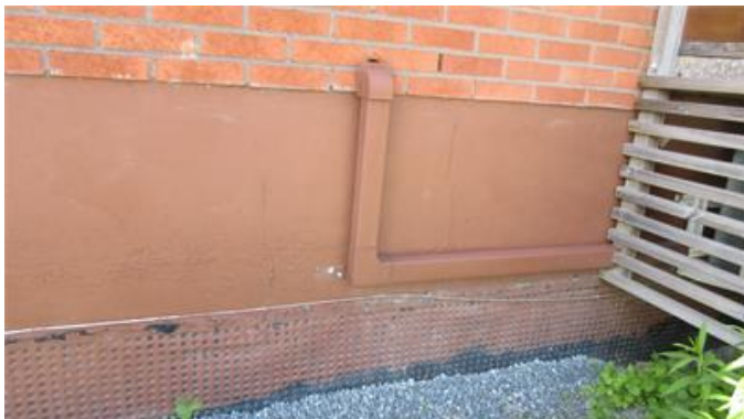
"Platonmatta" högt monterad och sprickor i grundmur.
