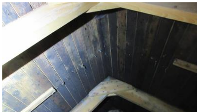
Mikrobiell påväxt pånockvindens underlagstak.
