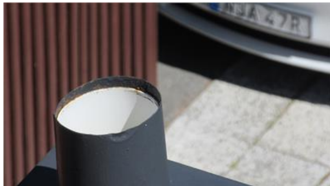
Otättheter i avloppsluftarens plåtinklädnad.
