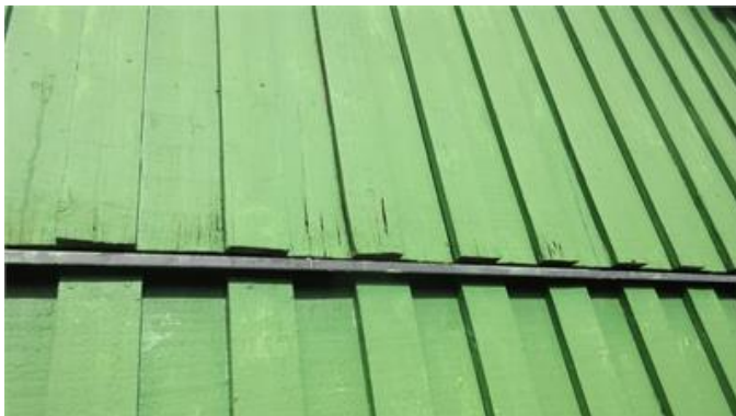
Rötskador i fasad.
