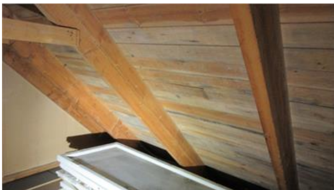
Mikrobiell påväxt pånockvindens underlagstak.
