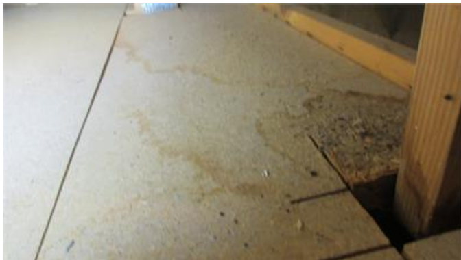
Missfärgning under fönster på sidovind.
