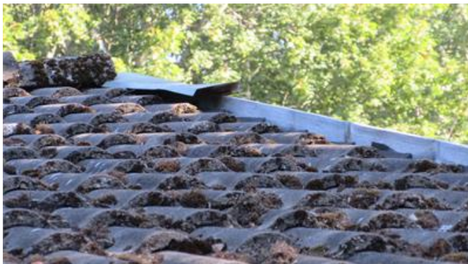
Plåt fattas på tak.
