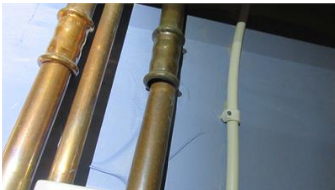
Brott på vattenrör.
