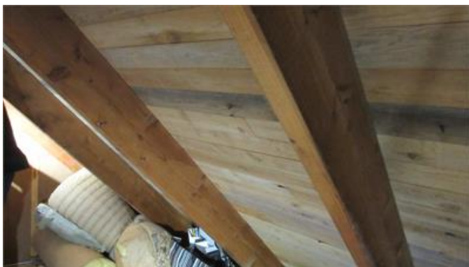
Mikrobiell påväxt pånockvindens underlagstak.
