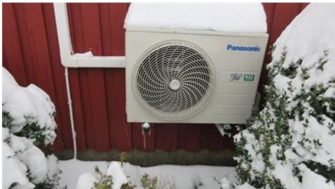
Värmepumpens utomhusdel monterad på fasad.
