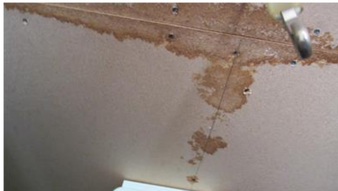
Missfärgning innertak förråd.
