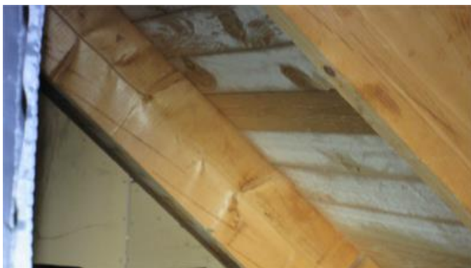
Mikrobiell påväxt pånockvindens underlagstak.
