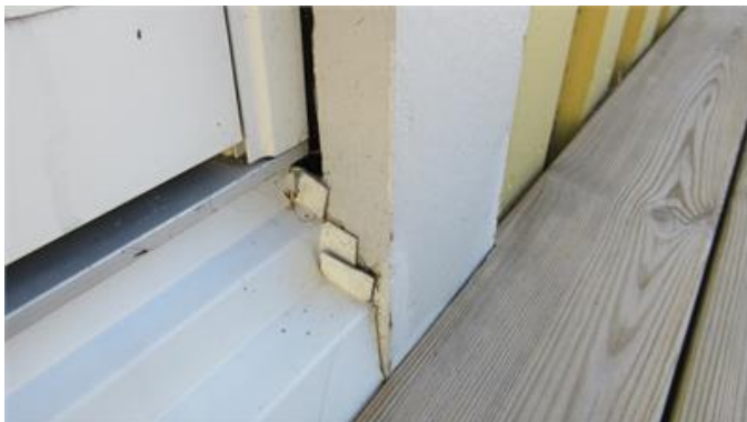
Otät plåt/infästning dörr.
