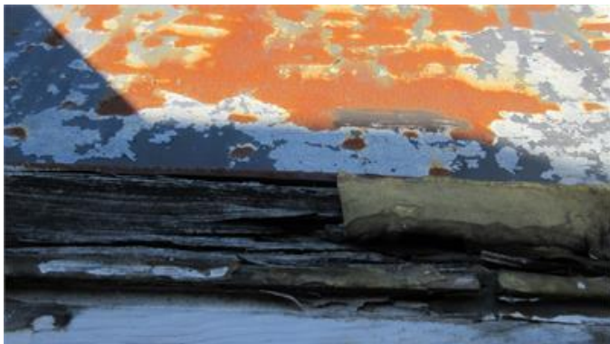
Rötskada i fönsterkarm och underliggande konstruktioner.
