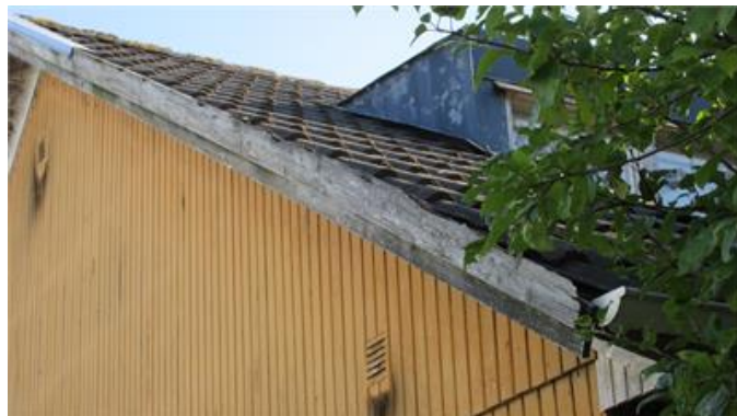
Röta vindskiva samt avsaknad av gavelbeslag.
