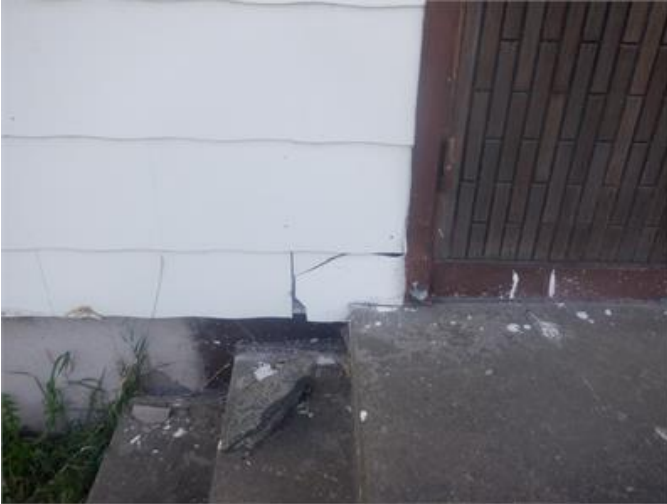
Bilden visar exempel på skadad eternitplatta på fasaden.
