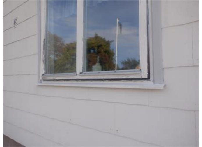
Bilden visar exempel på fönster med renoveringsbehov.
