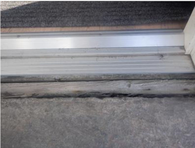
Bilden är tagen på entrédörren som saknar tröskelplåt.
