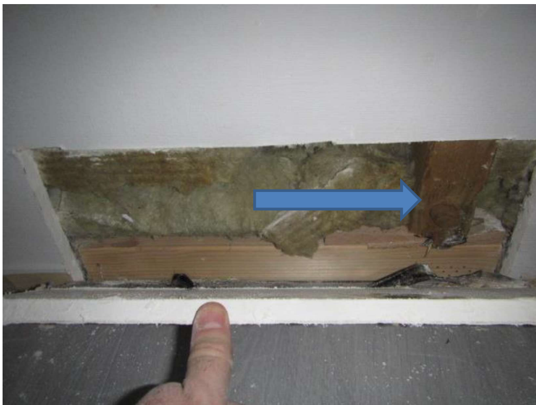
Bild 4. Rötskyddsbehandlad väggregel i matplatsens yttervägg.
