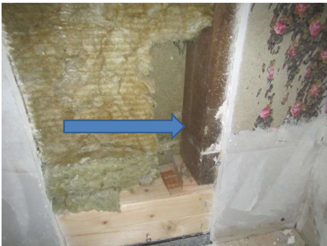
Bild 2. Väggregeln är rötskyddsbehandlad och avger en tydlig kemisk lukt.
