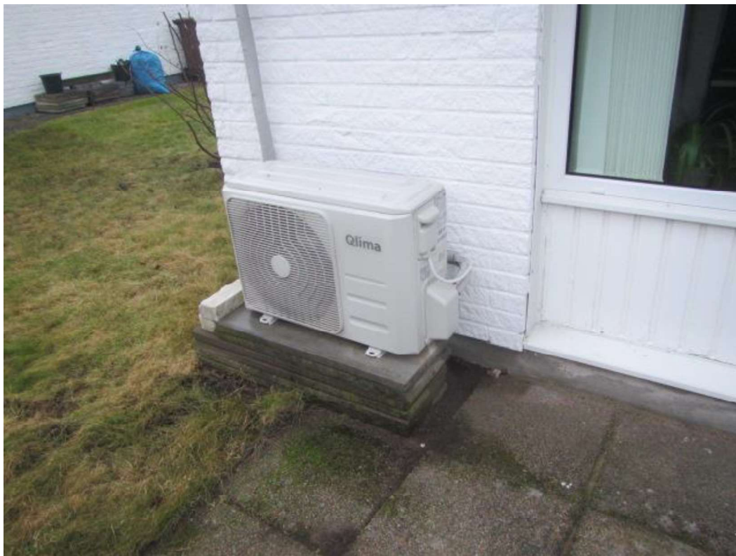
Bild 1. Kondensvatten från luftvärmepumpen leds inte bort från husgrunden.
