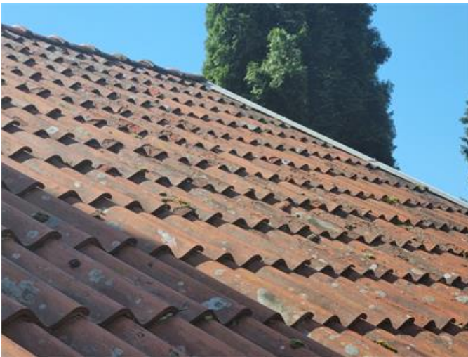
Översiktsbild, yttertak med defekta/frysskadade takpannor.
