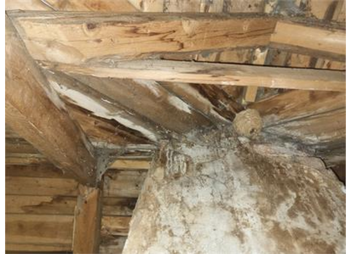
Exempelbild, fuktfläckar underlagstak, vind.
