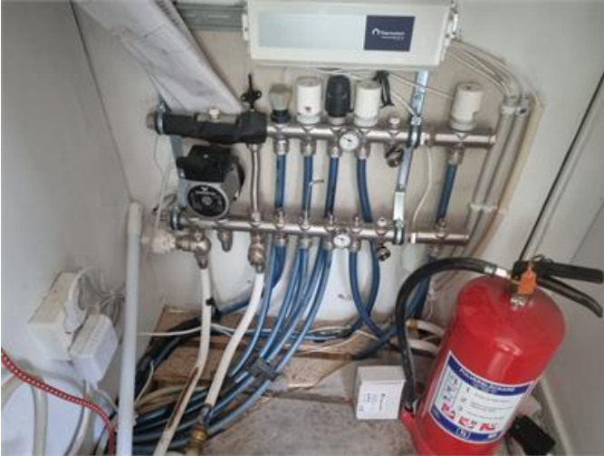
Exempelbild, golvvärmecentral utan vattentätt skikt under sig.
