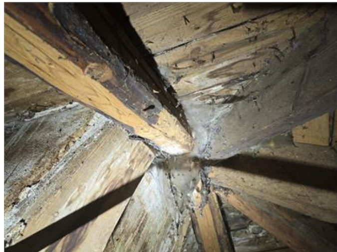
Exempelbild, fuktfläckar i underlagstak, vind.
