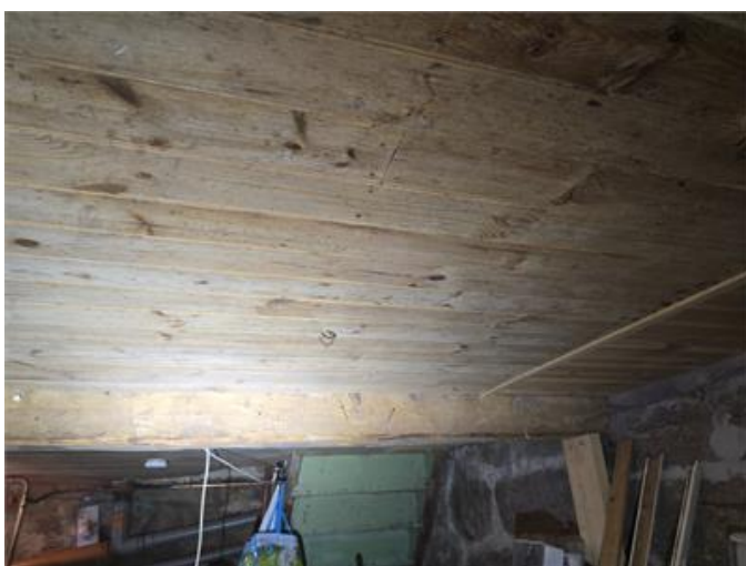
Exempelbild, mikrobiell påväxt innertak, källare.
