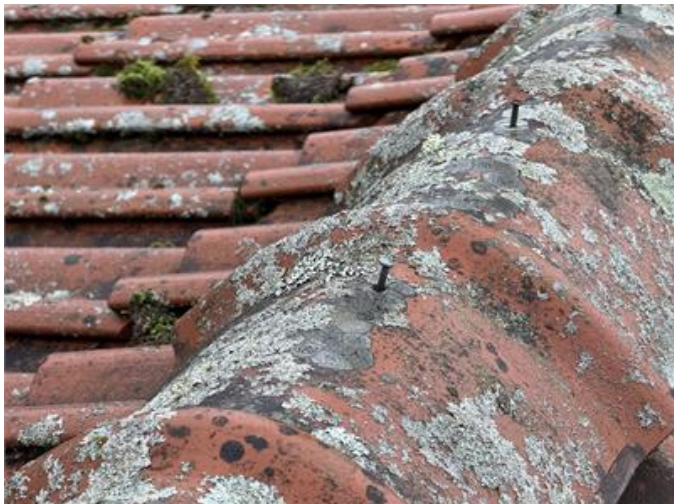
Exempel på spikar som rest sig vidnockpannor
