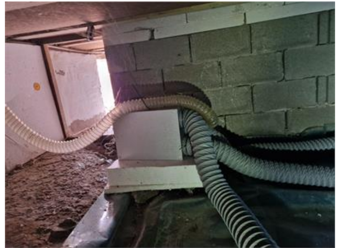
Vy i krypgrunden med avfuktare
