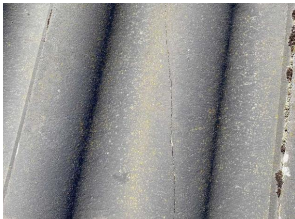
Bild 7: Utvändigt, Tak, En sprucken takpanna noterades
