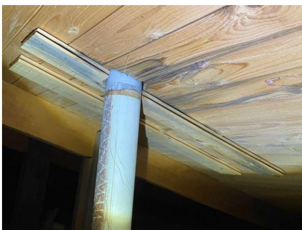
Bild 4: Utvändigt, Vind, Spår av tidigare läckage noterades
