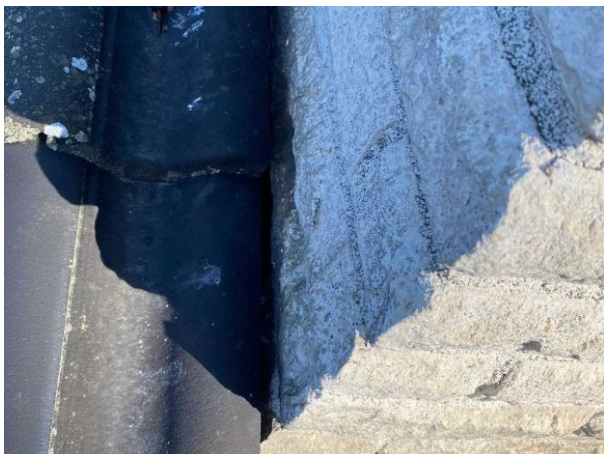
Bild 5: Utvändigt, Tak, Ståndplåt saknas runt skorstenen
