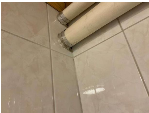
Bild 2: Invändigt, Souterrängplan, Duschrum/wc, Otäta rör genomföringar noteras i duschzonen samt under handfatet
