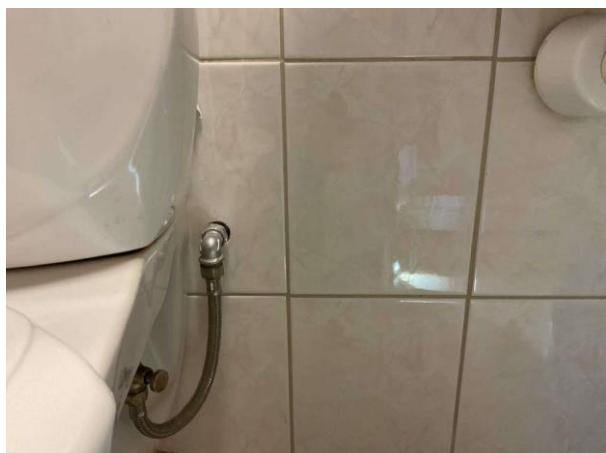
Bild 1: Invändigt, Souterrängplan, Duschrum/wc, Otäta rör genomföringar noteras i duschzonen samt under handfatet
