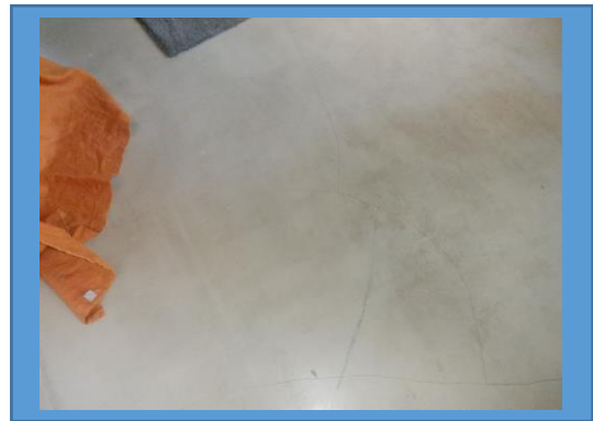
Sprickbildning i golvtytskikt
