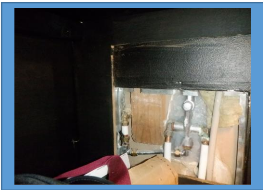
Rör genomföringar från badrum bakom blandare i klädkammare
