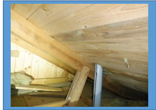
Missfärgningar/fuktfläckar på vind
