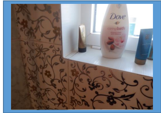
Sprickbildning i bruksfogar i badrum
