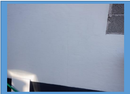
Sprickbildning i putsad fasad
