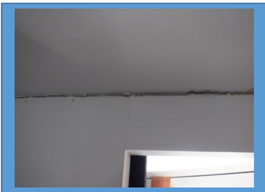
Sättning i takkonstruktion
