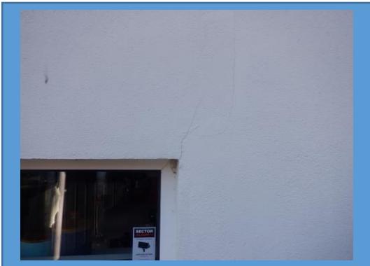
Sprickbildning i putsad fasad
