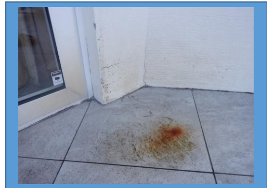
Lokala skador på putsad fasad
