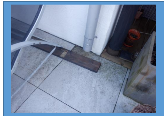
Stuprör mynnar ut mot grundmur/fasad
