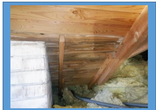
Missfärgningar/fuktfläckar på vind
