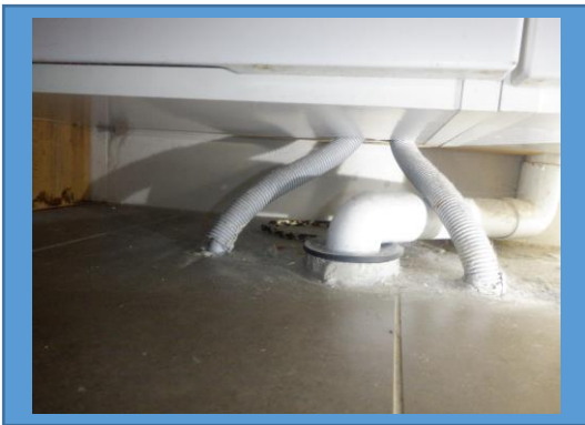
Rör genomföringar i golv i badrum
