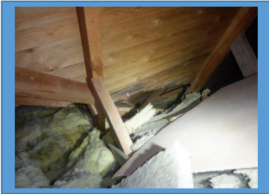
Missfärgningar/fuktfläckar på vind
