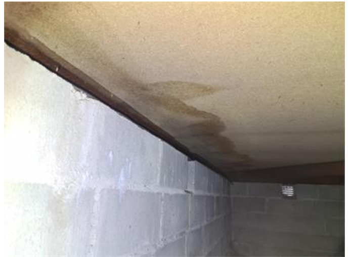
Krypgrund, missfärgningar/fuktanvisningar på blindbottenskivor södra gaveln.
