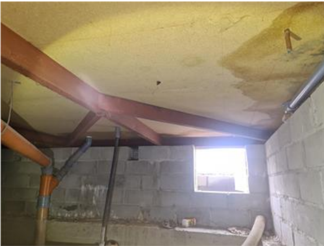
Krypgrund, missfärgningar/fuktanvisningar på blindbottenskivor nordvästra hörnet under våtrum.
