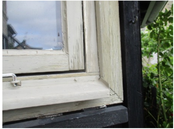
Foto 8. Eftersatt underhåll av fönster.
