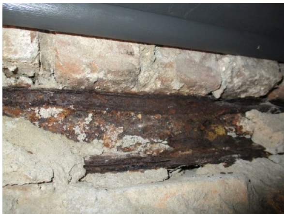
Foto 3. Rostskador på försäkring i grundmur.
