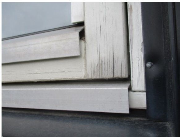
Foto 6. Eftersatt underhåll av fönster.
