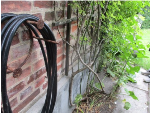
Foto 9. Växt nära byggnaden.
