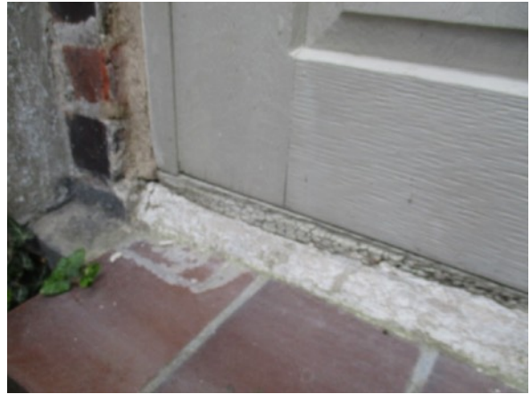
Foto 10. Rötskada på entrédörrens tröskel.
