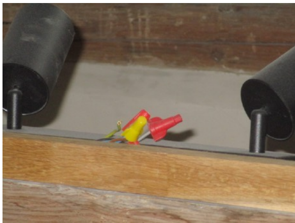
Foto 1. Lösa Kablar på takbjälke.
