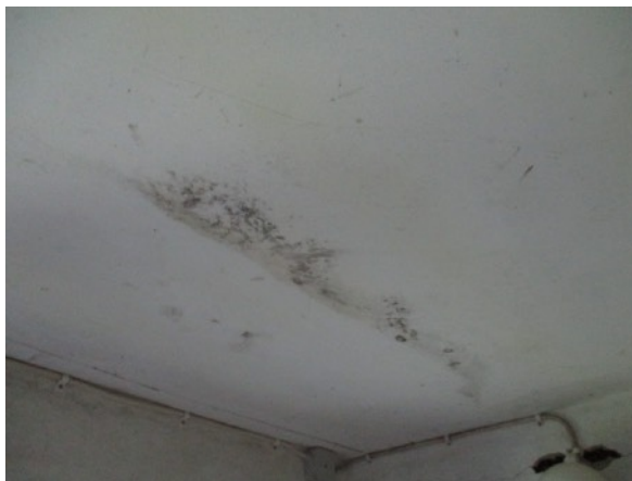
Foto 4. Mikrobiell missfärgning på förrådskak.
