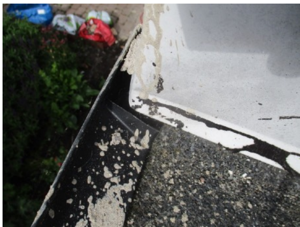
Foto 5. Avvikande plåtanslutning på förrådskak.
