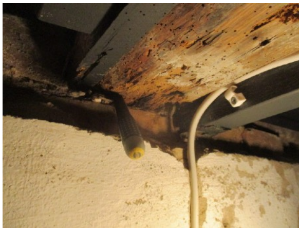
Foto 2. Rötskadad bjälke i källare.
