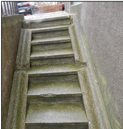
Källartrappa med skador
