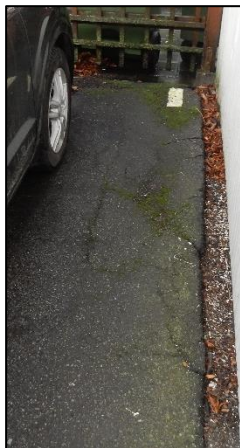
Asfalt med skador
