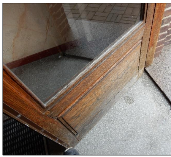
Trapphusentré med uttjänt virke
