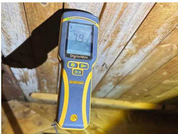
Bild 1: - Utvändigt, Vind, Huset är självdragsventilerat, se riskanalysen Lokal mikrobiell påväxt noterades Se riskanalys In...
