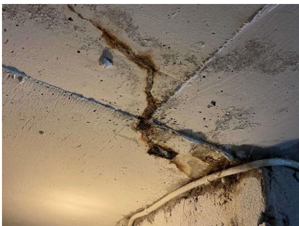
Bild 3: Utvändigt, Förråd, Rost noterades i en spricka under balkongen
