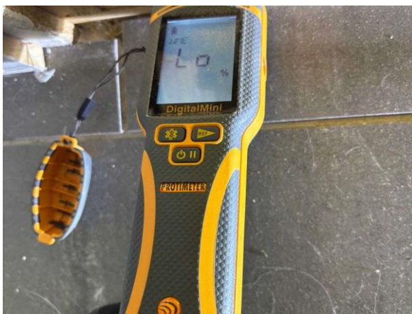
Bild 4: - Invändigt, Betongplatta på mark/inklädda källarväggar, Betongplattan är av äldre standard, se riskanalysen Det förekommer inklädda källarväggar med kons...
