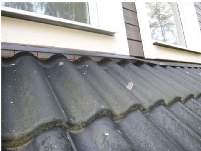
Bilden visar exempel på brister mellan taktäckningen och takkupan.
