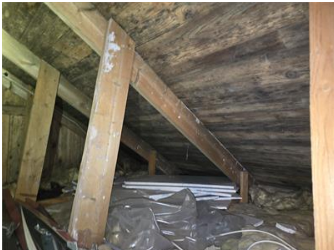
Exempel på mikrobiell påväxt på underlagstaket.
