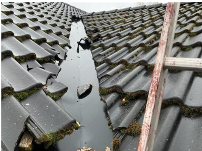
Trasiga takpannor invid rännal.
