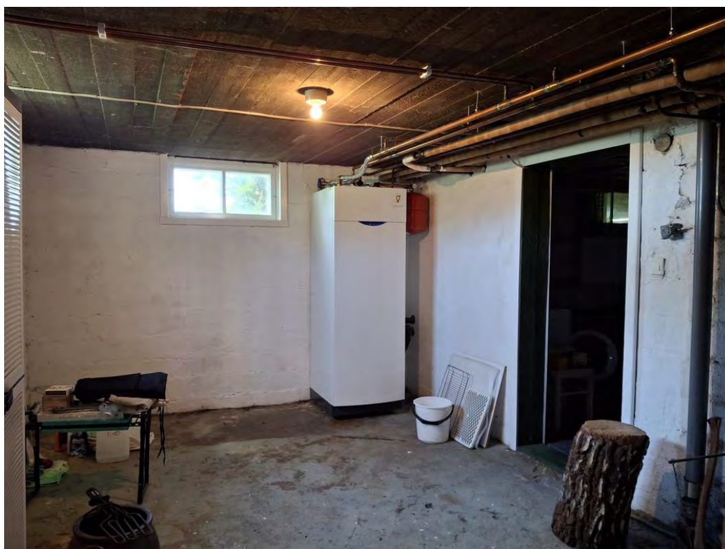
Pannrummet, gamla pannan finns kvar
