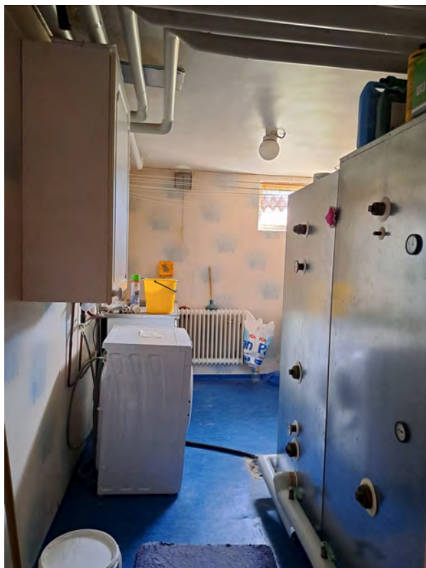
Tvättstugan, ackumulatortankar till höger
