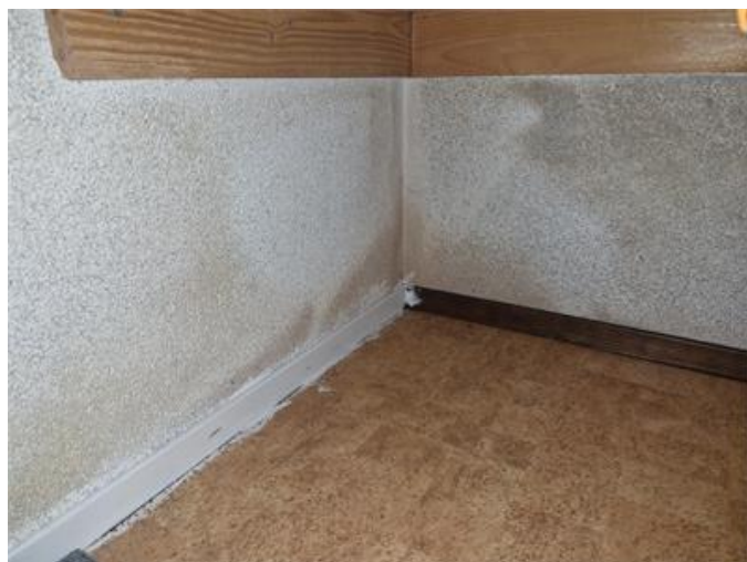
Sutterängplan Hobbyrum, missfärgningar på insidan av grundmuren.
