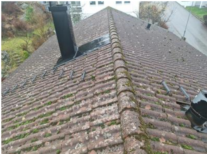
Tak, äldre pannor med mosspåväxt.
