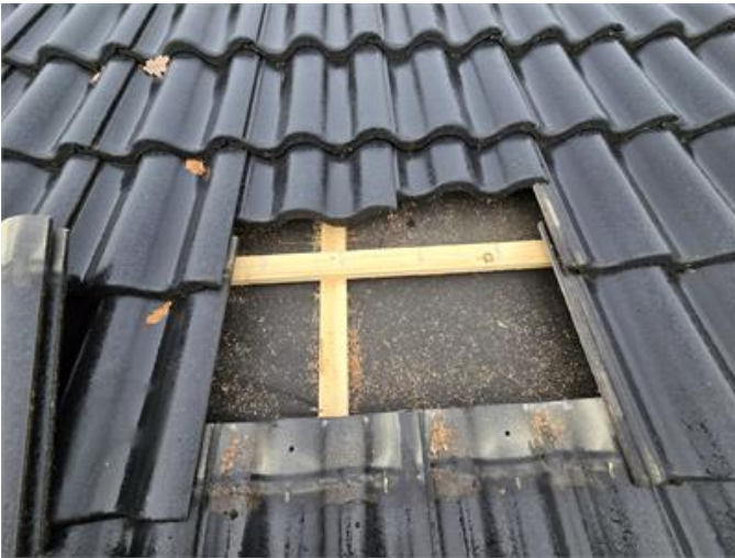
Tak: Stickprovskontroll under pannor, frömjöl noteras.
