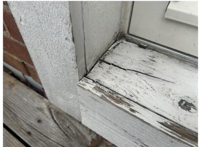
Träfasad: Rötskador runt t.ex. altandörr på östsidan.
