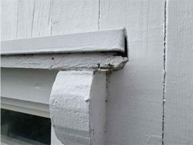
Fönster: Träkepsar inklädda med plåt, lokalt noterades rötskador i trädetaljer.
