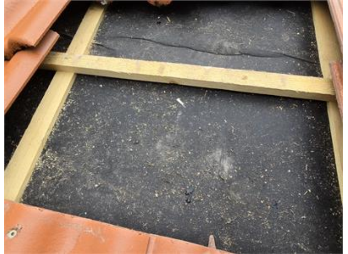
Tak: Stickprovskontroll under pannor, tunn ströläkt noterades.
