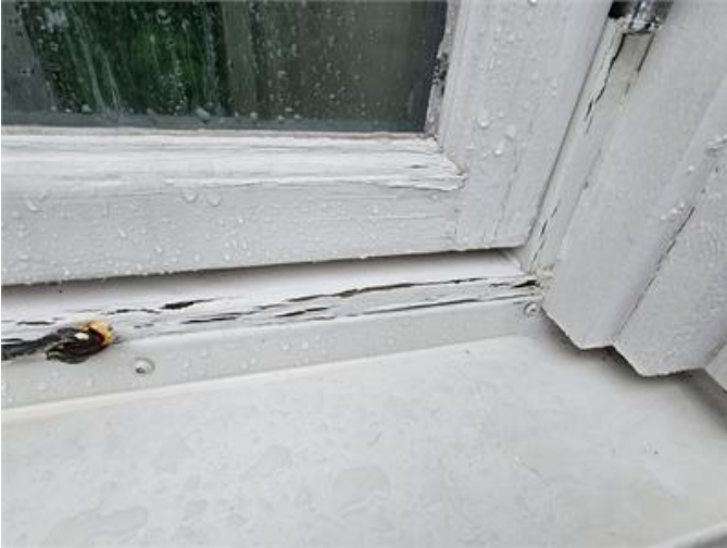
Fönster: Flertal fönster med underhåll/målningsbehov.
