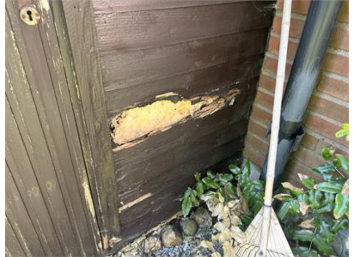
Träfasad: Rötskador/otätheter förekommer på flera ställen.
