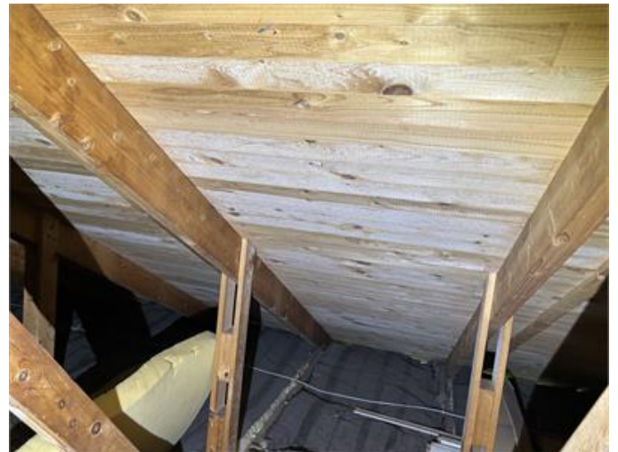
Nockvind: Mikrobiell påväxt noteras på flera ställen.
