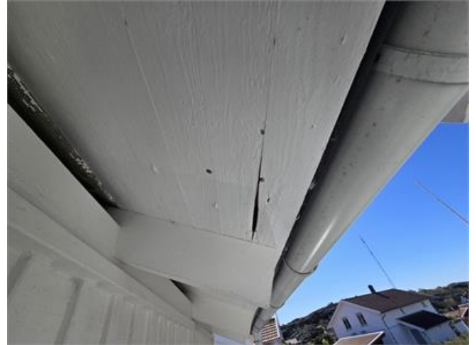
Tak: Mindre rötskada i råspont vid kök.
