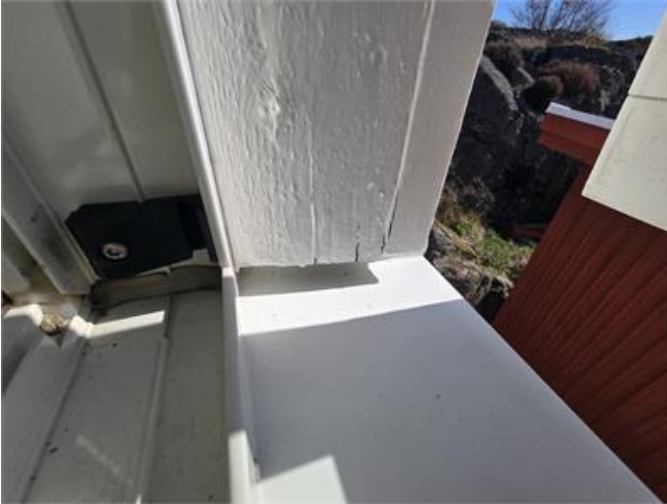
Fönster: Begynnande rötskada i nederkant salning vid fönster på Sovrum 4.
