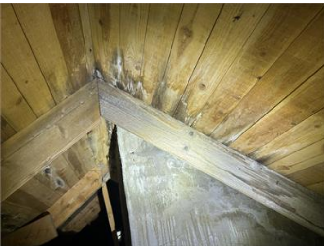
Nockvind: Fuktanvisningar förekommer bl..a. vid murstocken.
