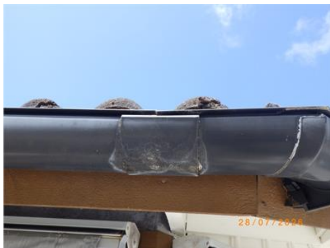
Spår av läckage vid rännskarv.
