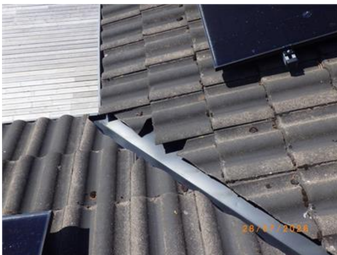
Trasiga takpannor i rännndal.
