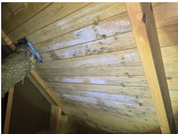
Nockvind: Mikrobiell påväxt på underlagstak.
