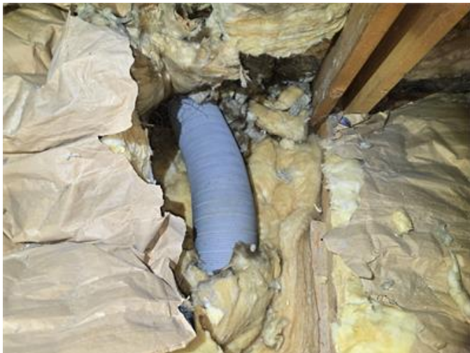
Nockvind: Imkanal bristfälligt isolerad vid genomföring.
