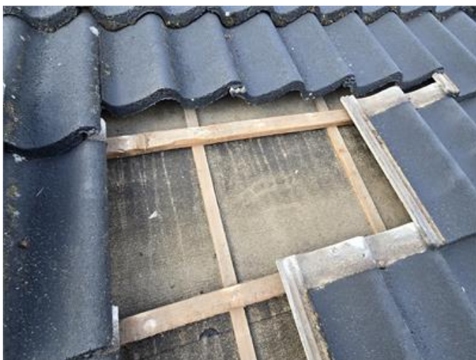
Tak: Stickprovskontroll under pannor, pappen är något spröd.
