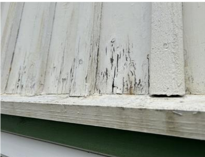
Fasad: Fönsterbrädor av trä och rötskador förekommer.
