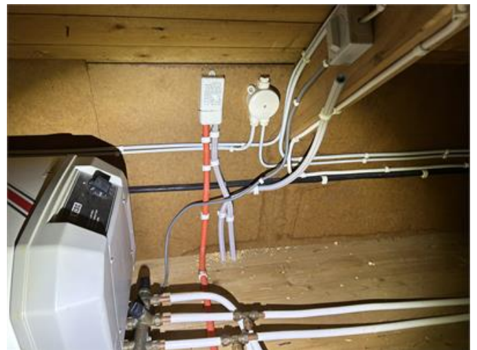
Sidovind norr: Varmvattenberedare finns i utrymmet.
