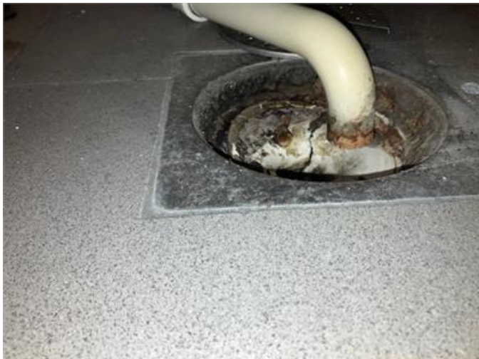
Golvbrunn utan synlig brunnsmanschett
