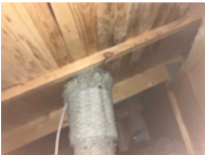
Fuktfleck i underlagstaket på vinden
