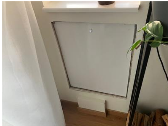
Fördelarskåp till golvvärme, placerat i ytterväggen
