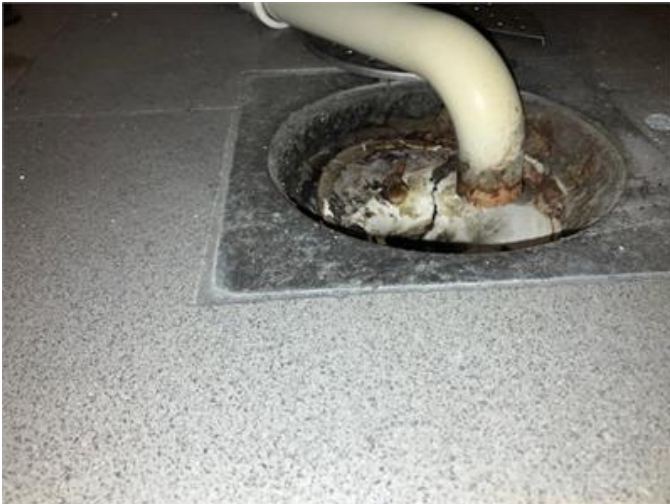
Golvbrunn utan synlig brunnsmanschett
