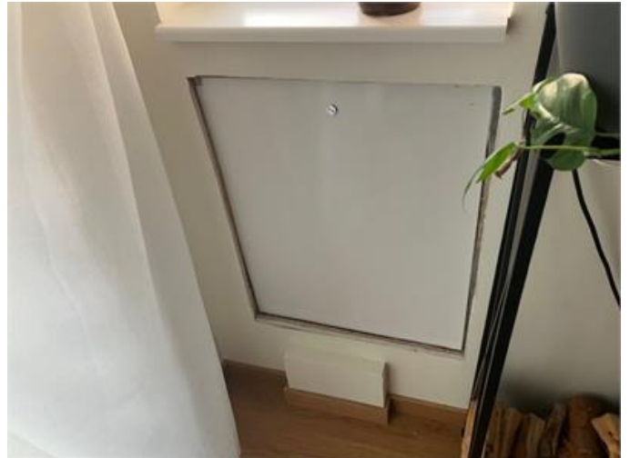
Fördelarskåp till golvvärme, placerat i ytterväggen
