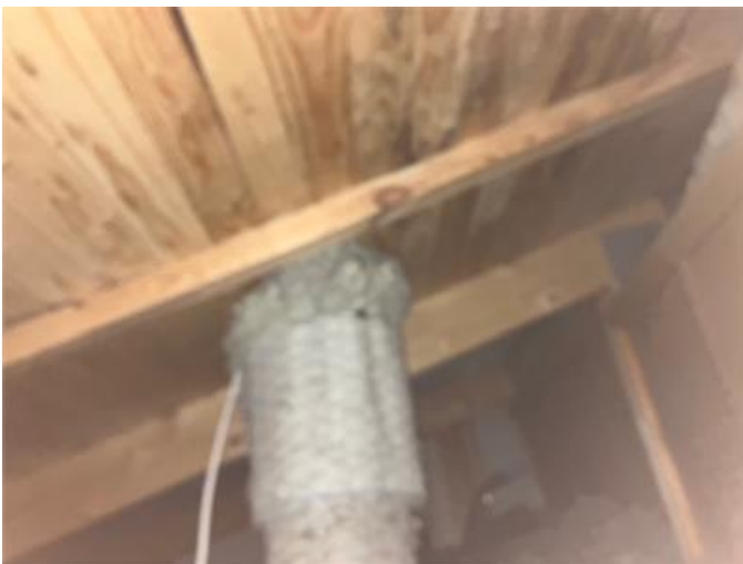
Fuktfläck i underlagstaket på vinden
