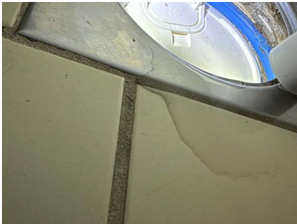
Bild 15: Invändigt, Källarplan, Tvättstuga Brunnsduk saknas i golvbrunnen
