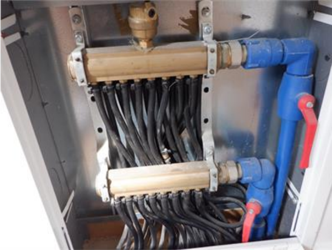
Golvvärmefördelare i skåp utan tät botten på samtliga plan.
