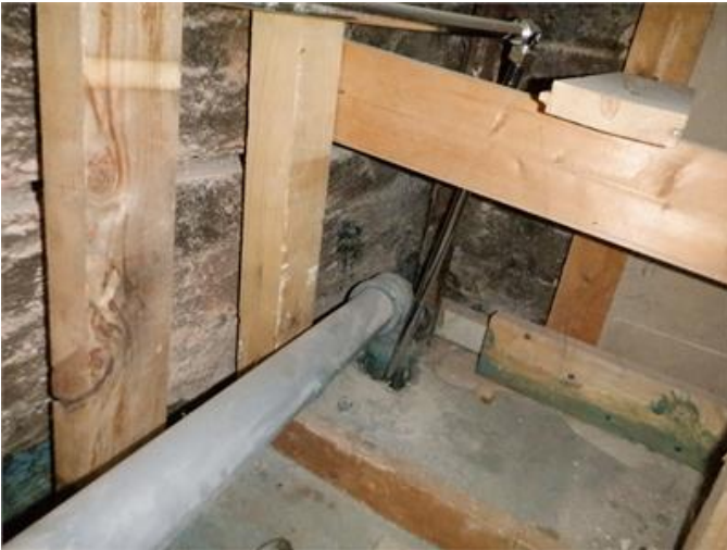
Bristfälligt tätskikt under handfat i badrum på entré plan.
