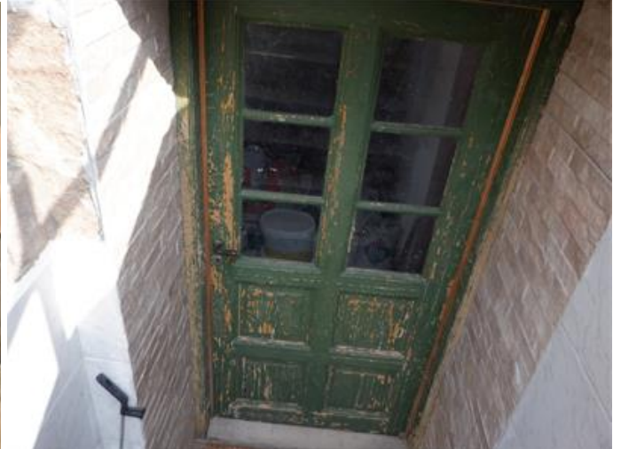
Källardörr med underhålls behov.
