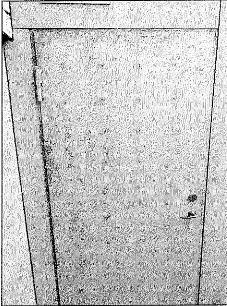
Bild 7 Källardörr med målningsbehov
