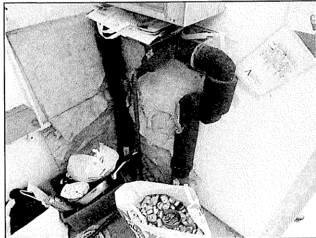
Bild 20 Huvudavstängning av vatten
