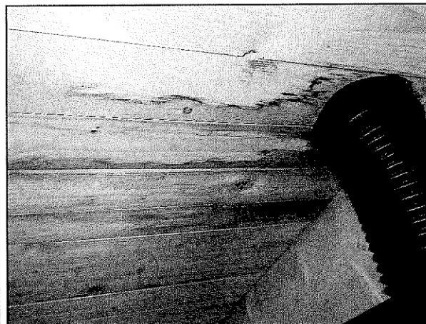
Bild 10 Genomföring för avluftare med fläckar
