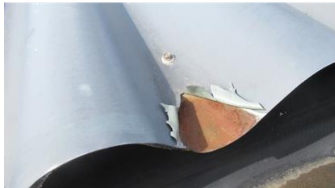
Rostangrepp på taktäckning.
