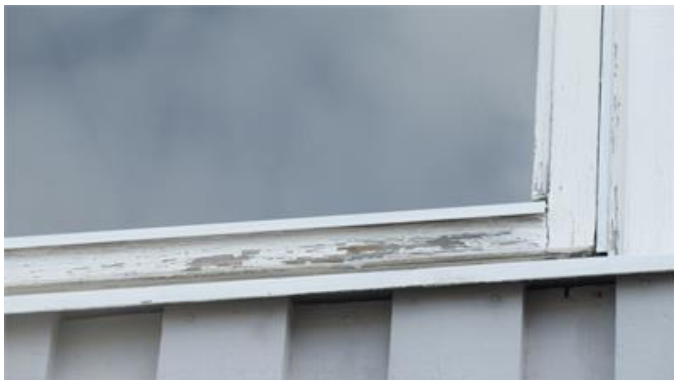
Fönster i behov av målning/underhåll.
