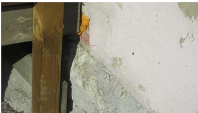
Putssläpp/sprickor i sockel/fasad.
