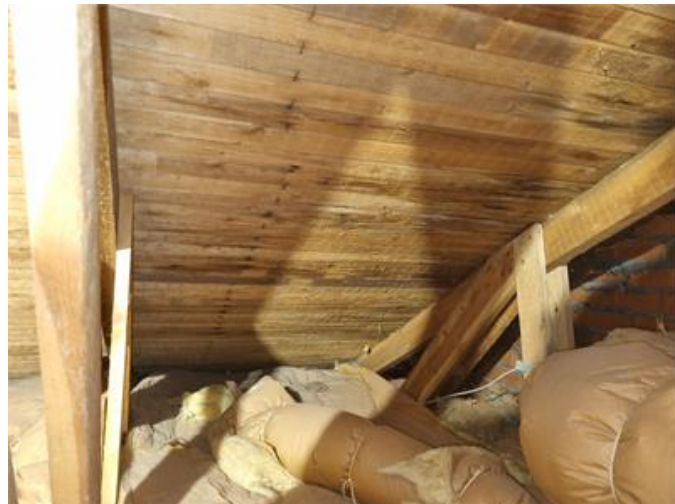
Bilden visar ett exempel på del av undersidan yttertaket med missfärgningar.
