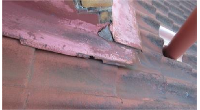
Rostiga plåtarbeten på tak.
