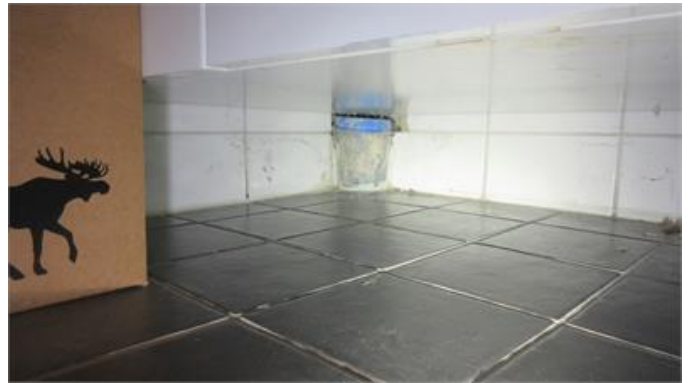
Rör genomföring i golv i tvättstuga källare.
