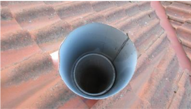
Otättheter mellan avloppsluftare och dess plåtinklädning.
