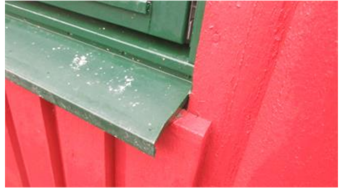
Otätthet plåt under fönster.
