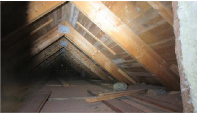
Mikrobiell påväxt pånockvindens underlagstak.
