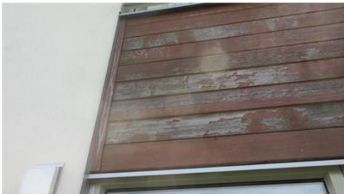
Träfasad i behov av underhåll.
