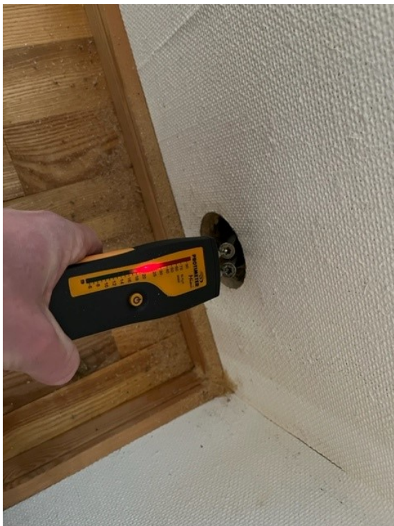
Fuktmätning i väggregel i gästrum via provhål.
